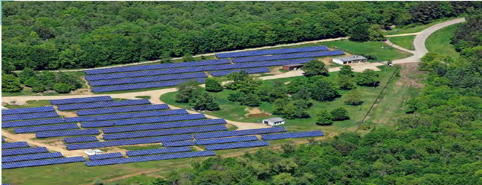
Photovoltaikanlage bei Weichering
